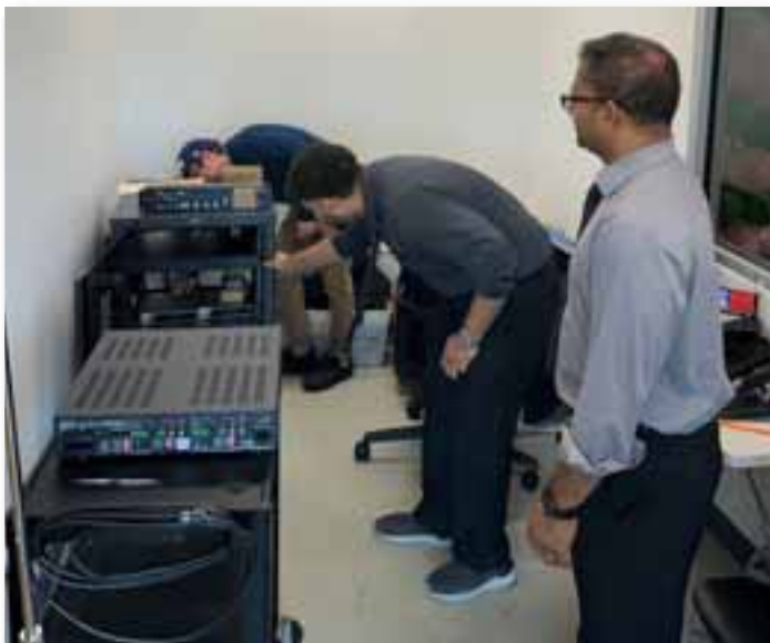
Welcome Center South Ballroom AV equipment upgrade.
